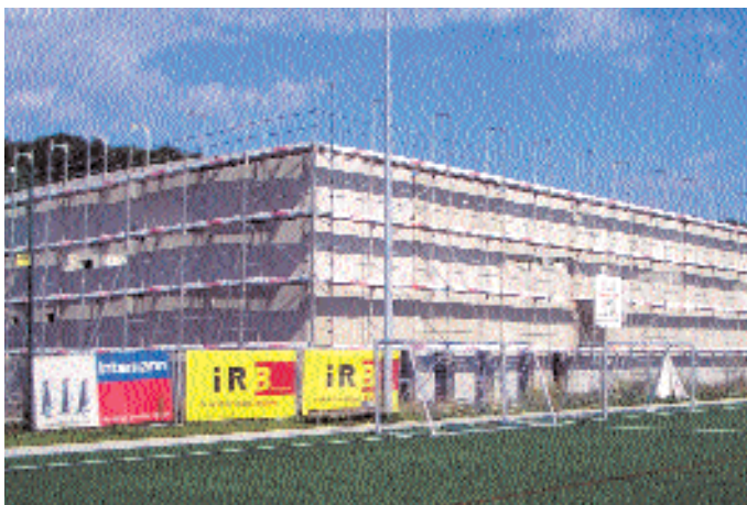
2008: Der Rohbau wurde gestoppt, die Bank drehte den Geldhahn trotz Zusagen ab.
